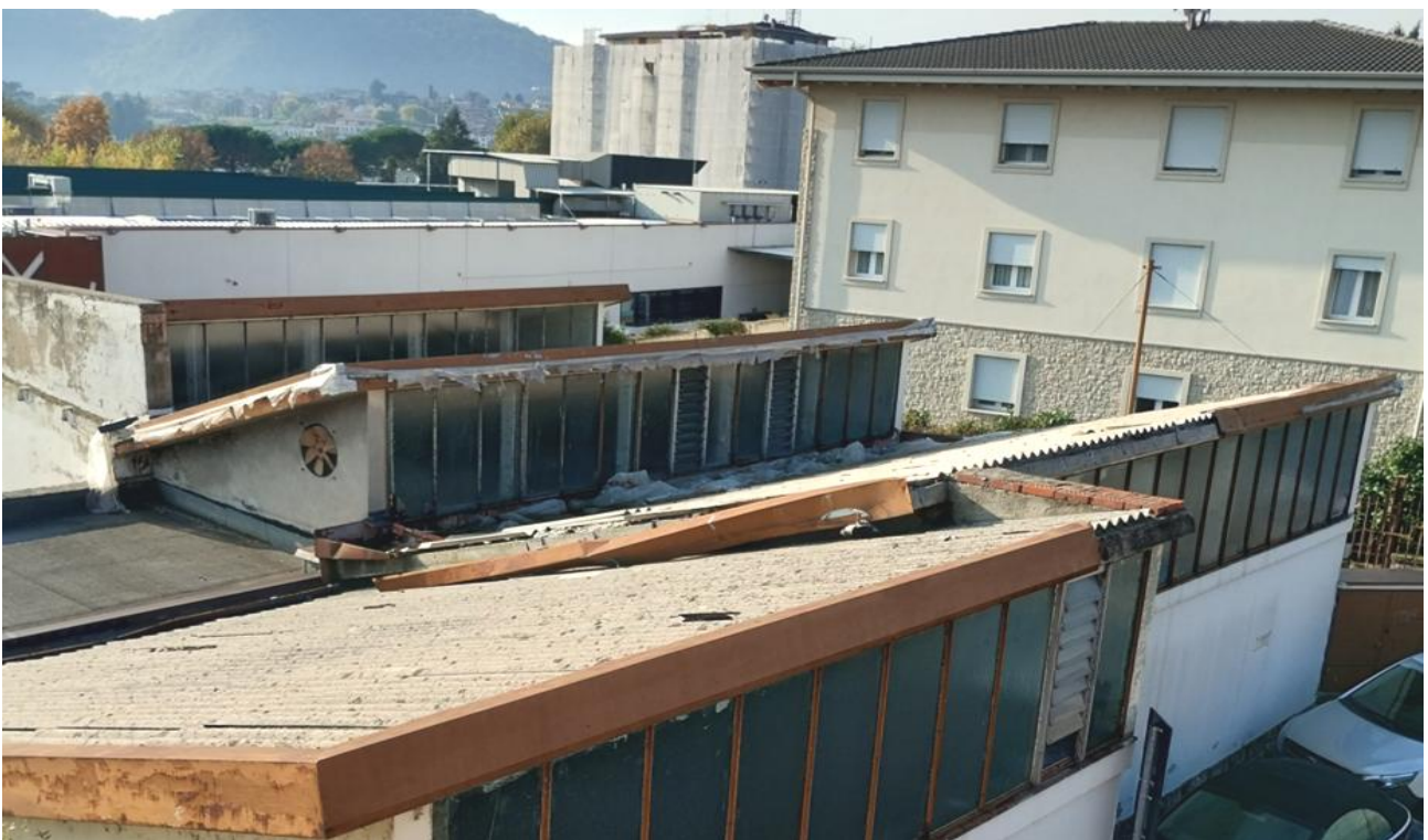
Vista 8 = coperture (foto effettuata dall'edificio in costruzione): dall'alto è visibile il degrado delle coperture; alcune porzioni erano temporaneamente state coperte con cellofan per evitare infiltrazioni; scossaline e canali sono arrugginiti e inutilizzabili.
